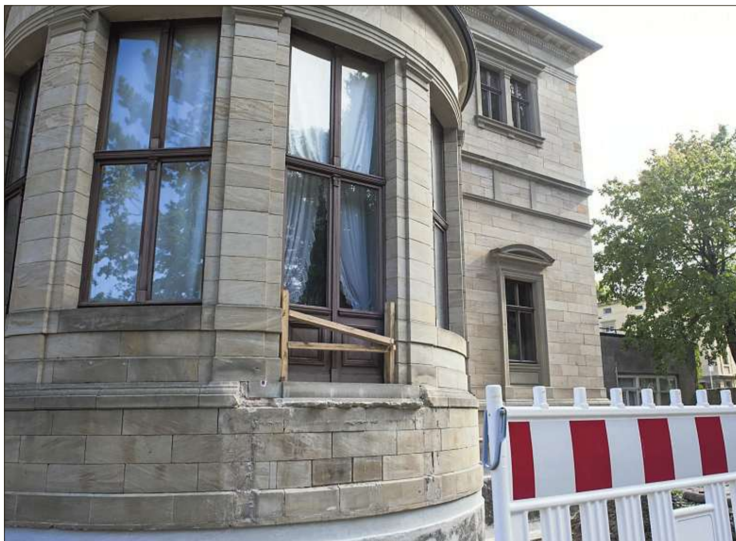
Die Rotunde von Haus Wahnfried – um die Fundamente abzudichten, haben Arbeiter die Treppe abgetragen. Die Steine lagern nummeriert im hinteren Teil des Gartens und werden nach Abschluss der Arbeiten wieder an ihren angestammten Platz gebracht. Fotos: Harbach
